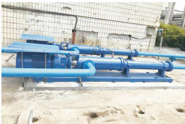
Моноблочный насос перекачивает водоугольную суспензию
