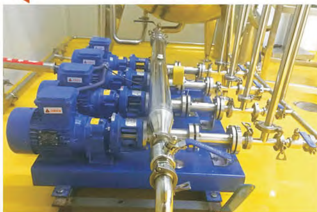
Дозирующий насос транспортирует раствор китайской медицины
