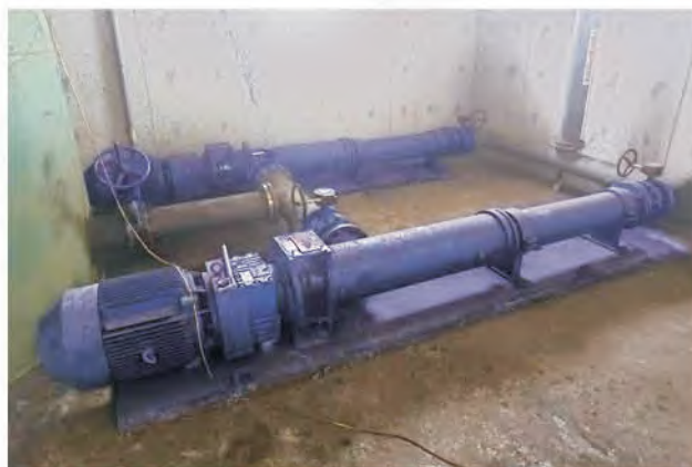
Моноблочный насос перекачивает водоугольную суспензию
