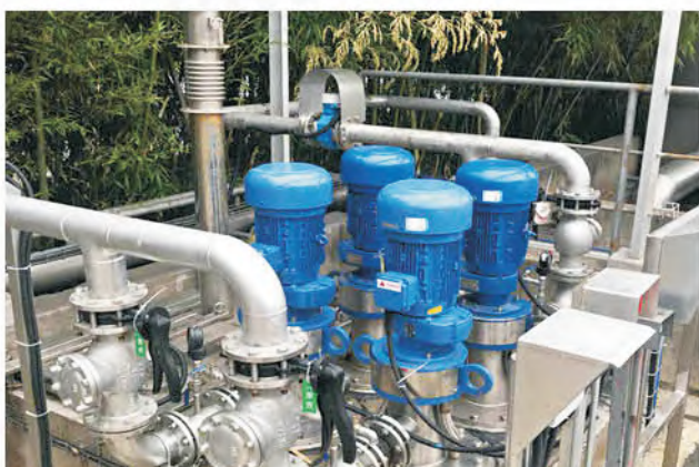
Вертикальный насос перекачивает активную глину
