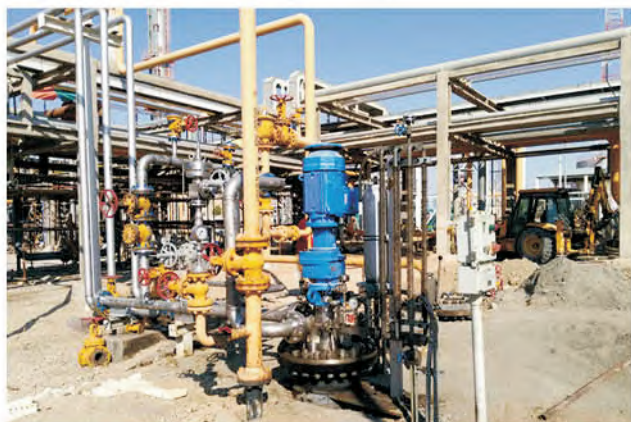
Вертикальный насос перекачивает водонефтяную смесь
