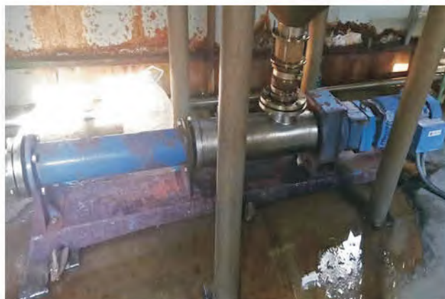
Моноблочный насос транспортирует закваску
