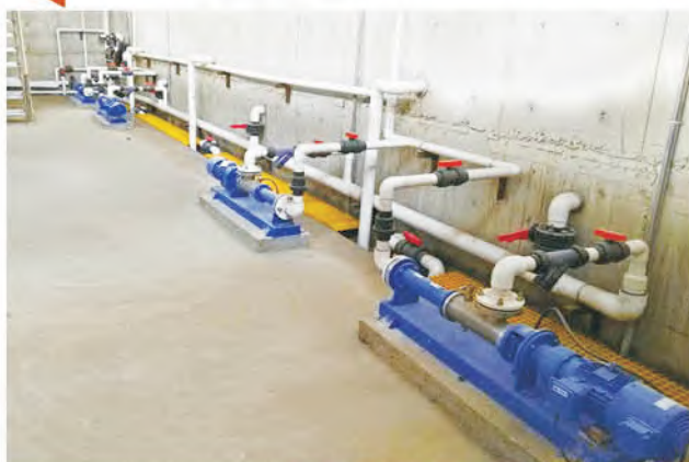
Дозирующий насос перекачивает ПАМ
