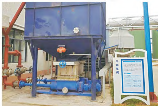
Бункерный насос транспортирует смесь кухонных отходов
