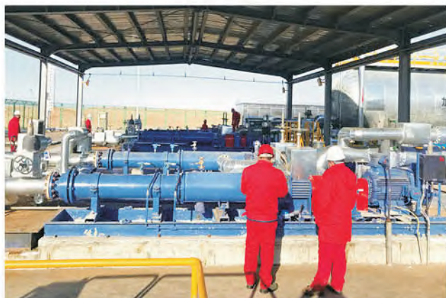
Насос с подшипниковой коробкой транспортирует нефть, содержащую воду
