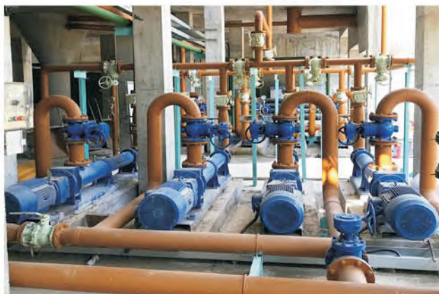
Моноблочный насос транспортирует сточные воды на металлургическом заводе
