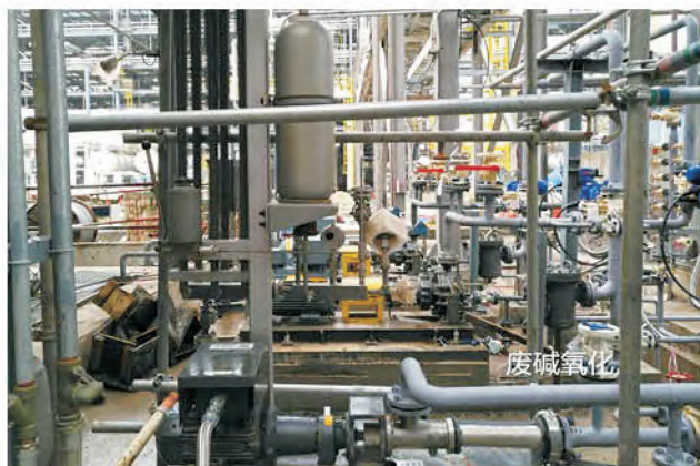
Дозирующий насос транспортирует углеводороды C6-C8
