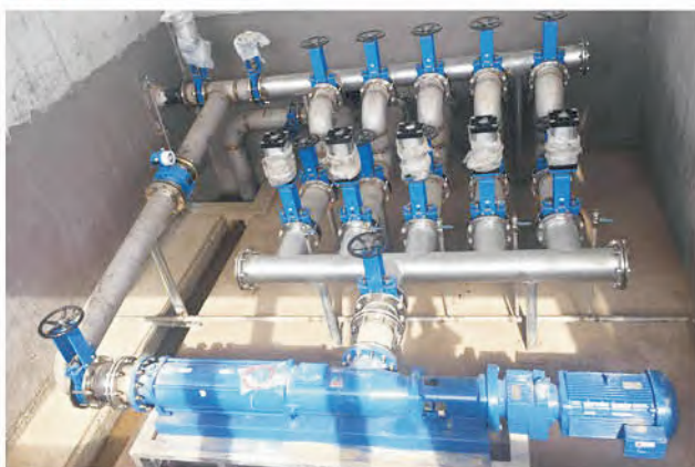
Моноблочный насос перекачивает биогазу из навоза
