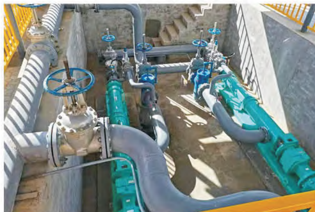
Высоконапорный насос на дальнее расстояние транспортирует водонефтяную смесь
