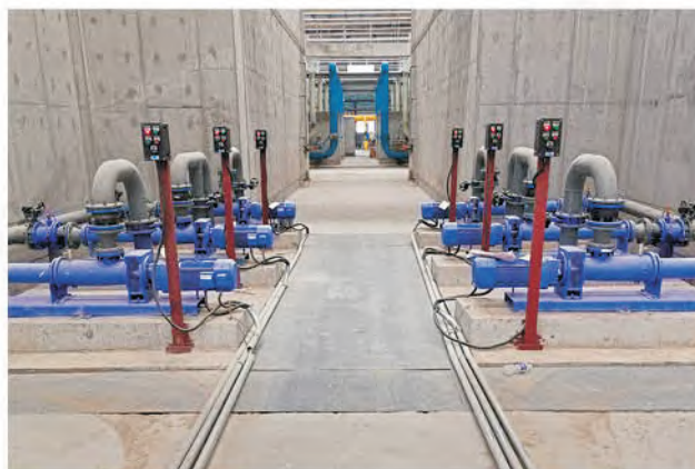
Моноблочный насос транспортирует сточные воды
