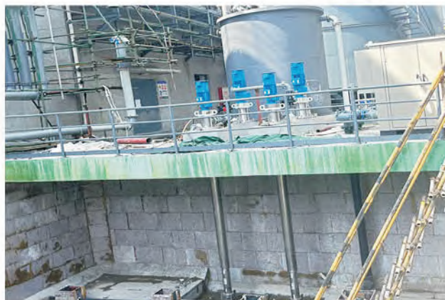
Вертикальный насос перекачивает сточные воды на электростанции
